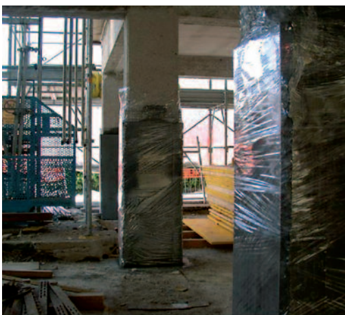
Figura 12 Fase 4 - Completamento cassetteria pilastri e travi con collaggio del micro calcestruzzo fibro-rinforzato dal piano superiore.
